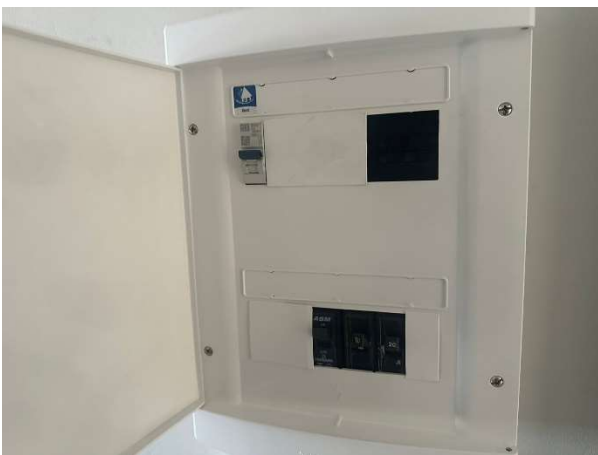
QUADRO DE DISTRIBUIÇÃO
